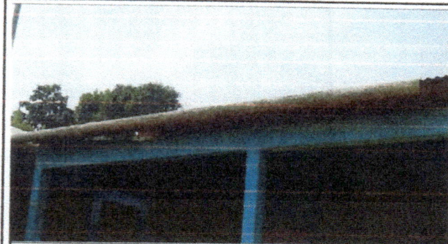
Foto 1: Sustrucción de canales de agua plubial ya que se encuentran en mal estado.
